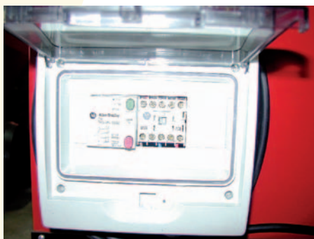
Figura 1 quadro di alimentazione della caldaia
